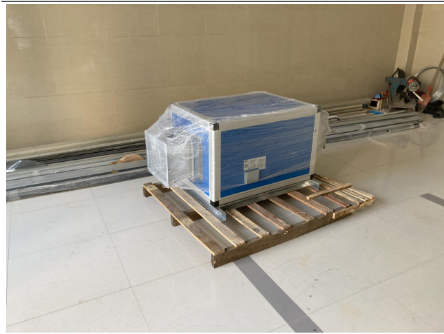
安装前非洁净区吊顶夹层的活性炭吸附箱（实际已安装）
