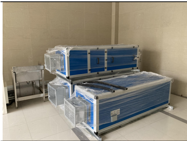
安装前洁净区吊顶夹层的活性炭吸附箱（实际已安装）
